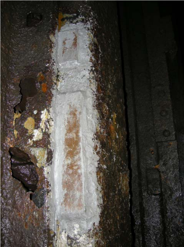
Schadstelle unmittelbar nach Beschichtung mit MM-metal UW
