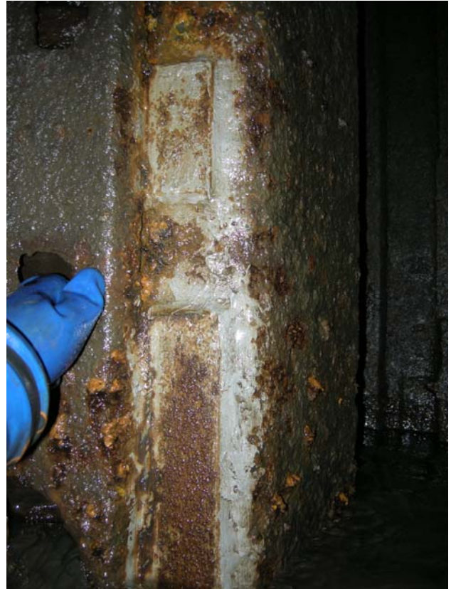
Schadstelle ca. ein Jahr später
